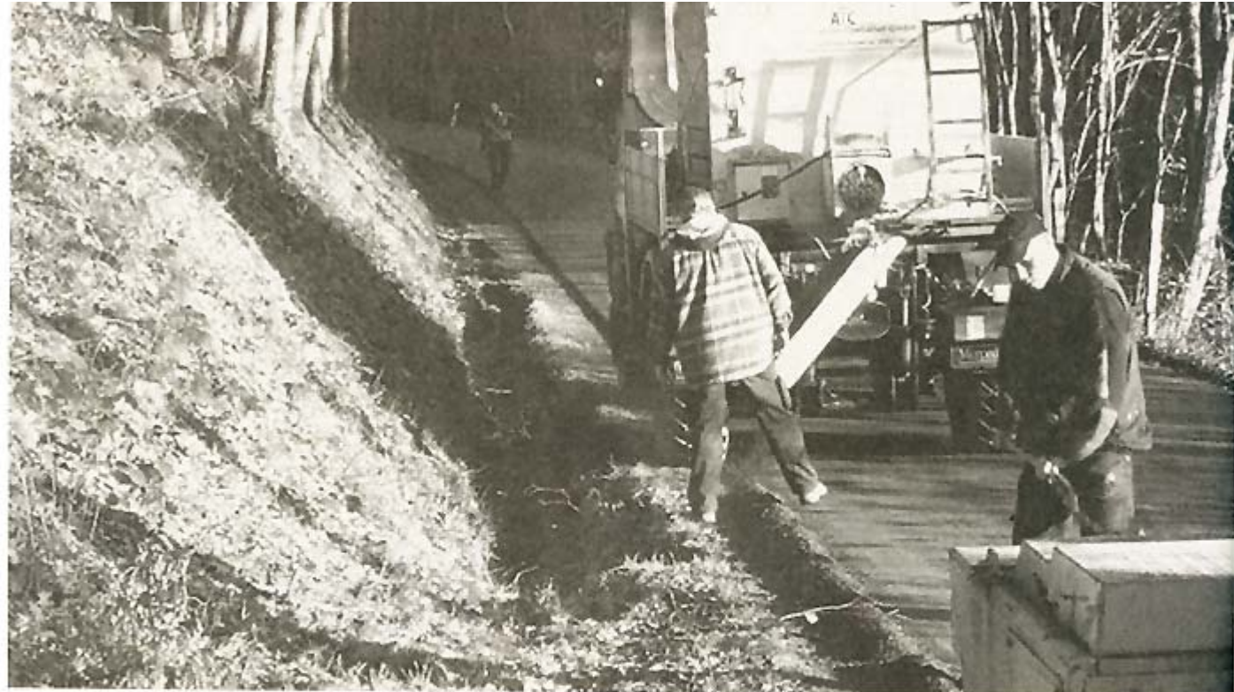
Für den Materialeinbau, inklusive aller erforderlichen Nebenarbeiten, werden insgesamt lediglich zwei Mitarbeiter benötigt, bei minimalem Maschineneinsatz.
